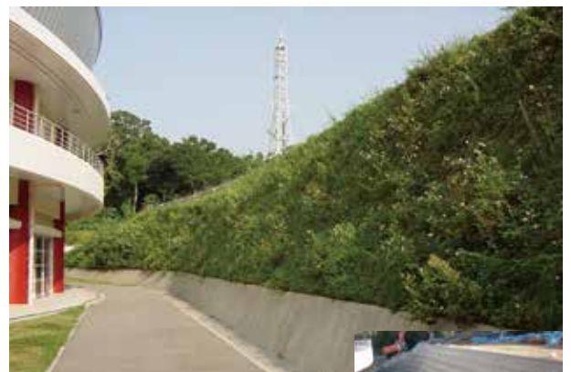
施工場所 沖縄県 壁面材 フラットパネル 壁高 4.98 m 壁面勾配 1 : 0.5
