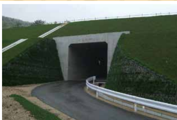
施工場所 福島県 壁面材 フラットパネル 壁高 8.29 m 壁面勾配 1 : 0.3
