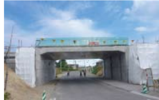
建設中のGRS一体橋梁（木古内） 2011年11月 GRS-integral bridge under construction (Kikonai) August 2012
