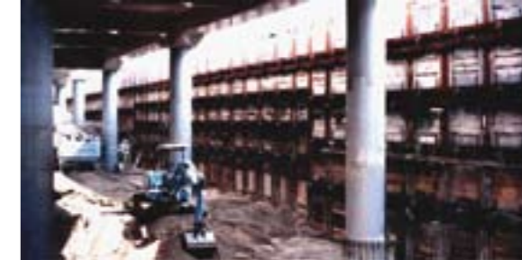
仮土留め施工例 九州旅客鉄道 箱崎高架 JR-Kyushu, Hakozaki (temporary wall)
