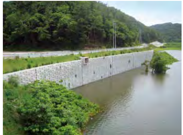
前面河川（水没状況）
