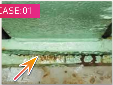
すべり面からの腐食
