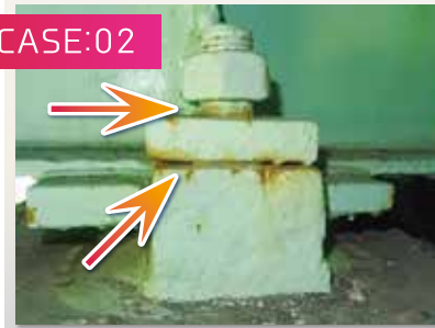
ピンチプレート付近からの腐食
