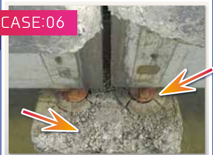
下部工の損傷
