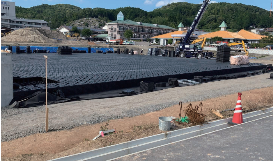
地下貯留槽「ジオプールAE-1」
